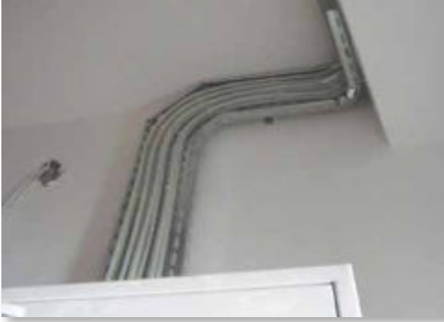
Kablolar bina içerisinde tek bir kanala döşenirler.
